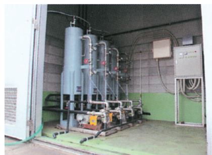
オゾン水ミキシングタンク
